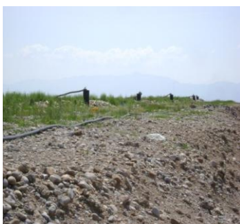
Slika 14 Biotrni za biogas
