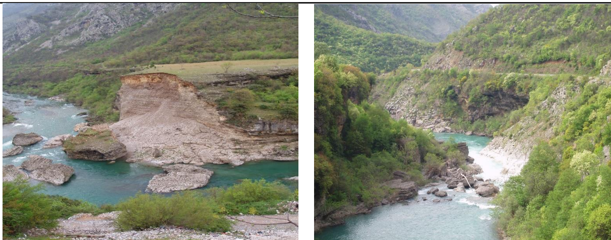
Slika br. 2.5. Narušena stabilnost većeg bloka terasnih sedimenata područje buduće akumulacije „Zlatica” i veći blokovi otkinuti duž rubnih dijelova riječne terase, područje buduće akumulacije „Milunović”
