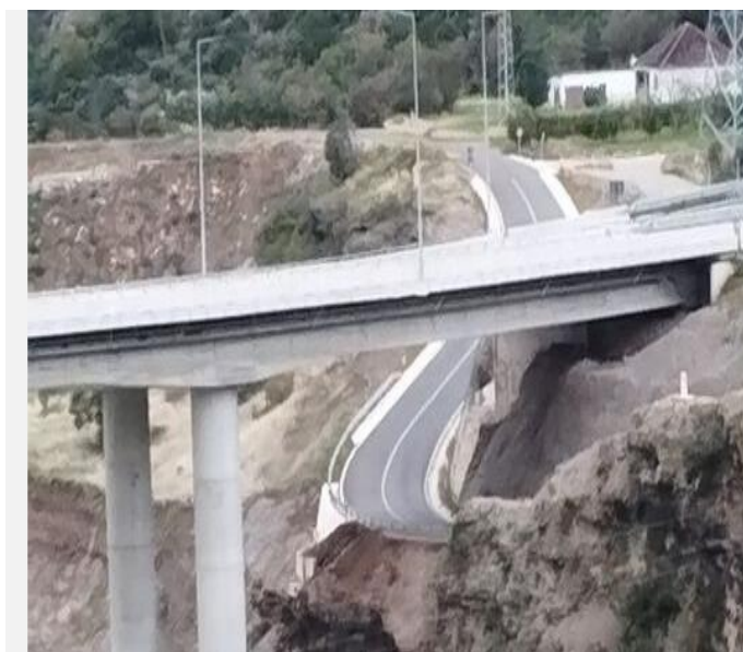
Slika br.2.13. Klizište na autoputu
