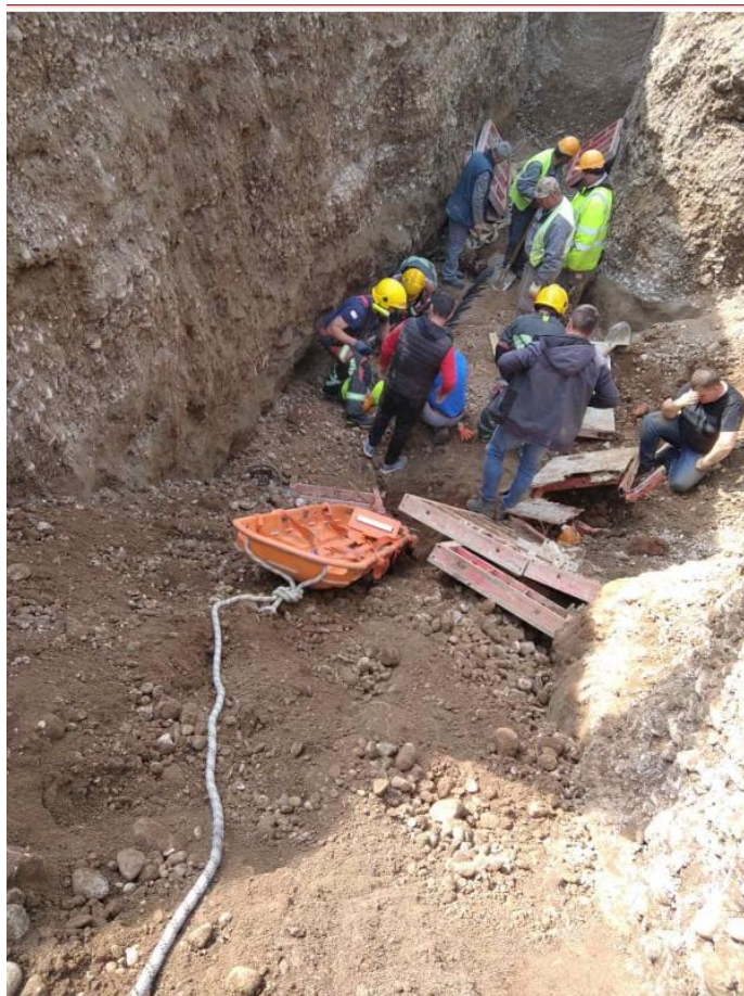
Slika br. 2.12. Odron na gradilištu u Gornjoj Gorici-Izvor: Služba zaštite i spašavanja Podgorica
