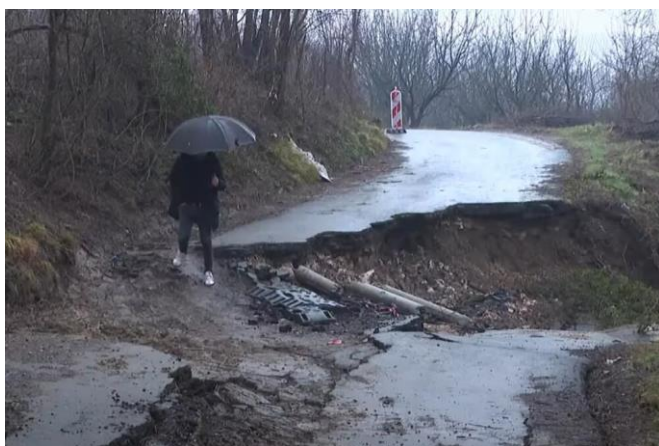
Slika br. 2.16. Klizište na putu Pričelje - Spuž
