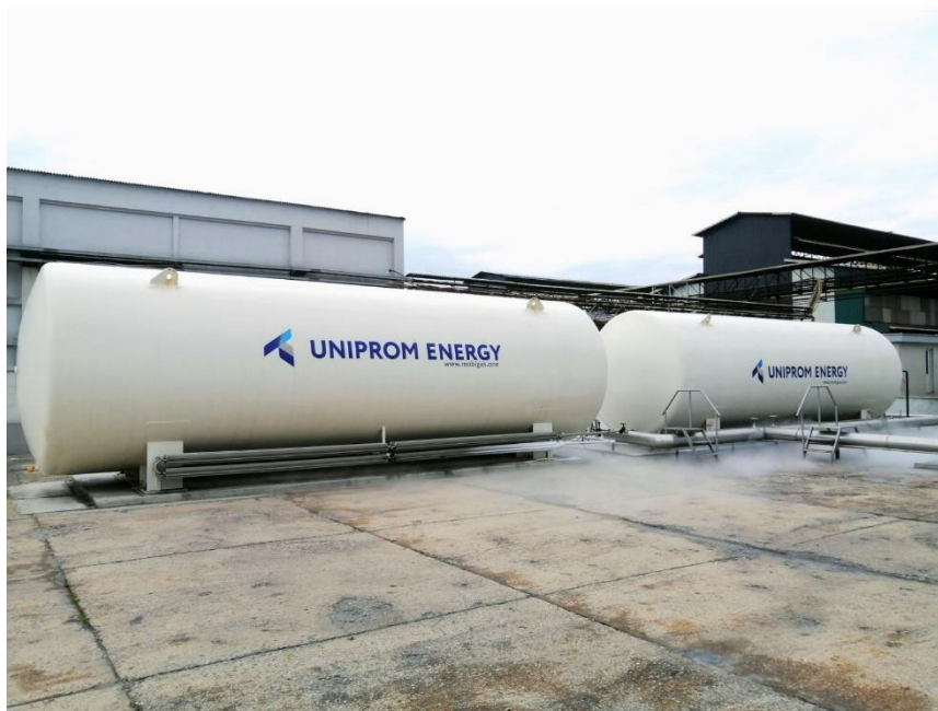
Slika br.2.8. Postrojenje tečnog prirodnog gasa, u vlasništvu “UNIPROM ENERGY” DOO
